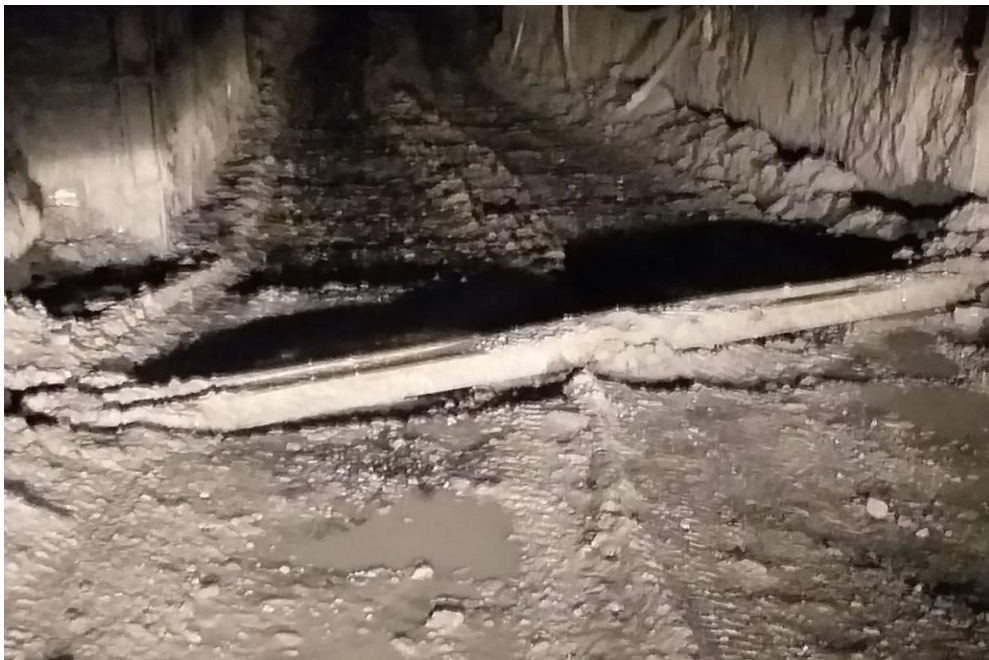
Condiciones del interior de la mina en mal estado, estas evidencias se envía directamente a la empresa titular para su respectivo mantenimiento,
