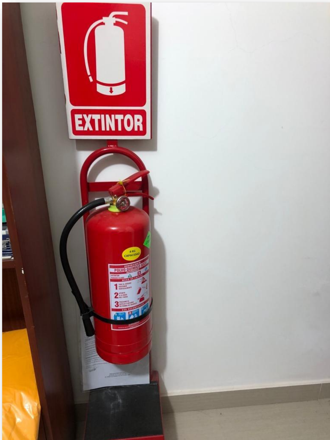
Figura 18. Ubicación del extintor en un lugar visible.
